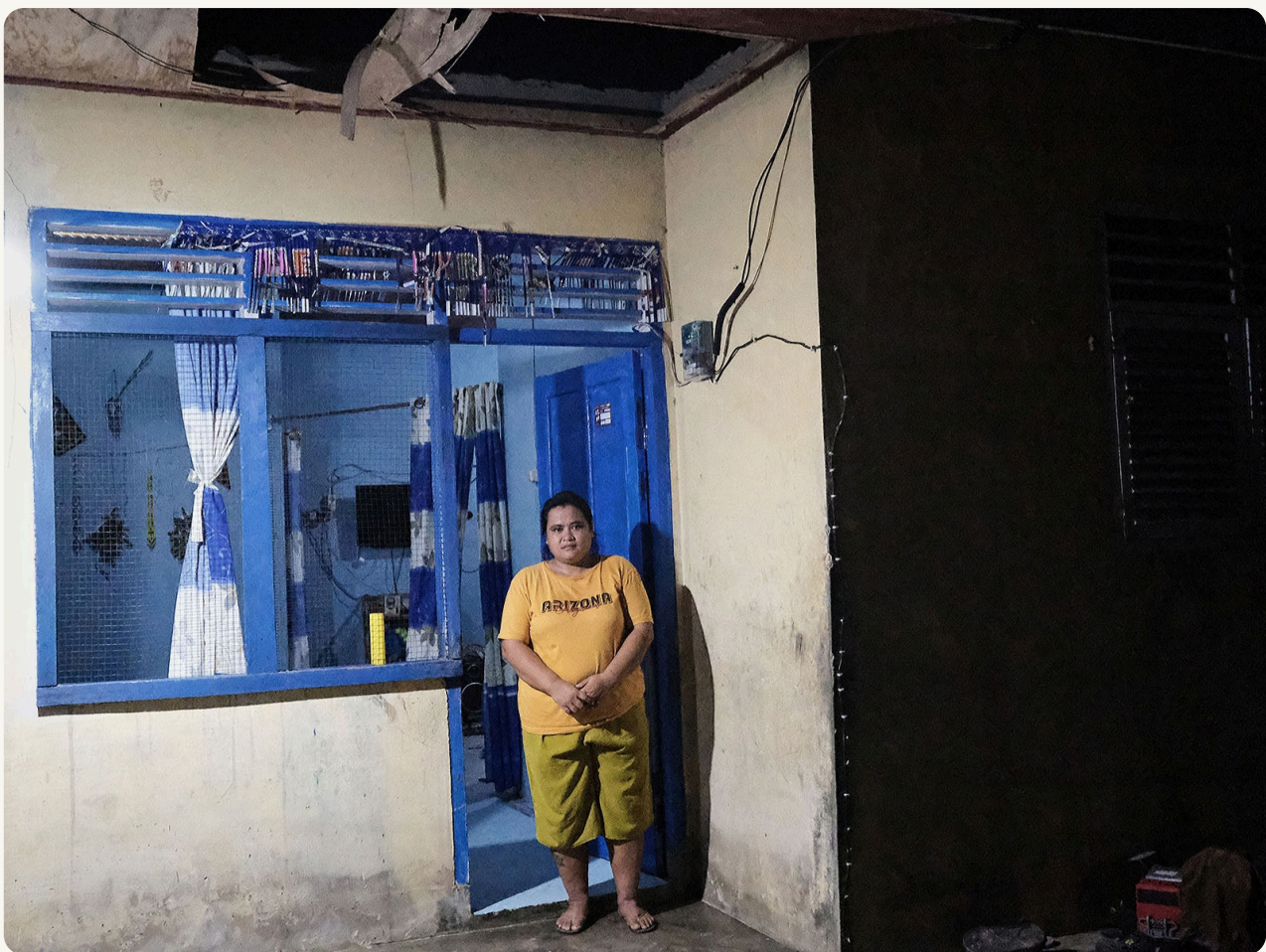
Franciska di depan bangunan rumahnya hasil relokasi oleh perusahaan dengan iming-iming menjadi pekerja tetap. Rumah aslinya telah dibakar habis dan lahannya diratakan oleh perusahaan. Bangunan rumah pemberian perusahaan telah bolong-bolong. Franciska juga kesulitan mengakses air bersih. (Project M/Permata Adinda)
